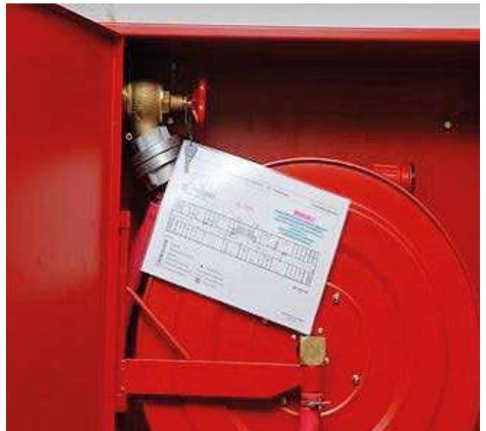
Slika 5: Notranji hidrant na Filozofski fakulteti (UL); priložena je shema lokacije glavnih električnih stikal s ključkom za dostop za izklop elektrike pred začetkom gašenja z vodo. Foto: Tomaž Flis
