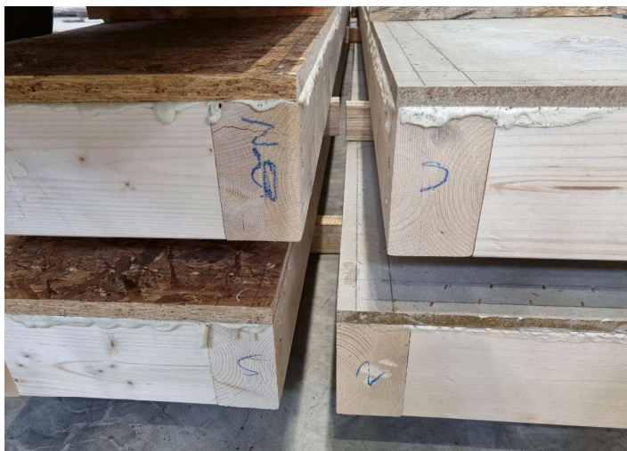
Slika 1: Kompozitni leseni nosilci pred oblaganjem z mavčno kartonskimi ploščami, osebni arhiv U. Blumauer.
