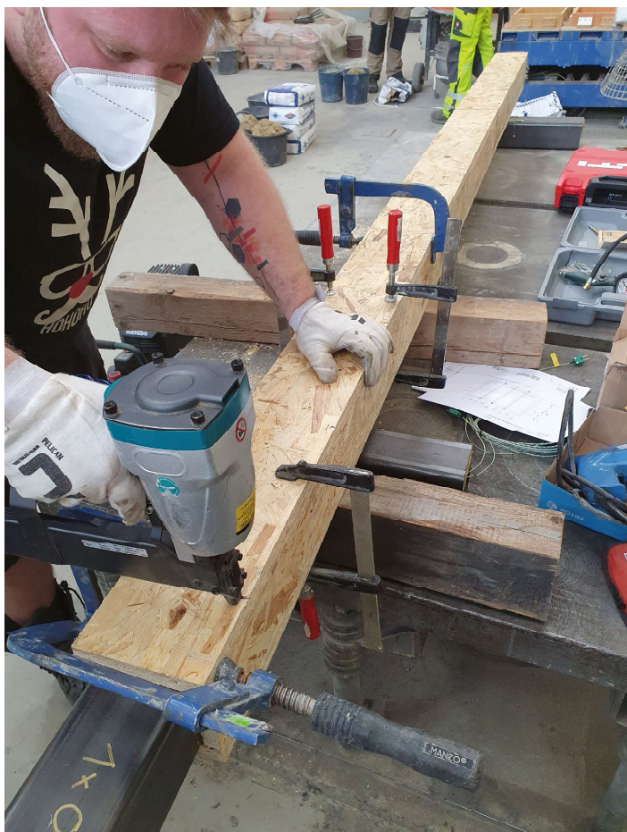
Slika 3: Spenjanje zaščitne lesene OSB-obloge okoli jeklenega nosilca pred požarnim preskusom v češkem požarnem laboratoriju Pavirus. (Foto: CVUT)
