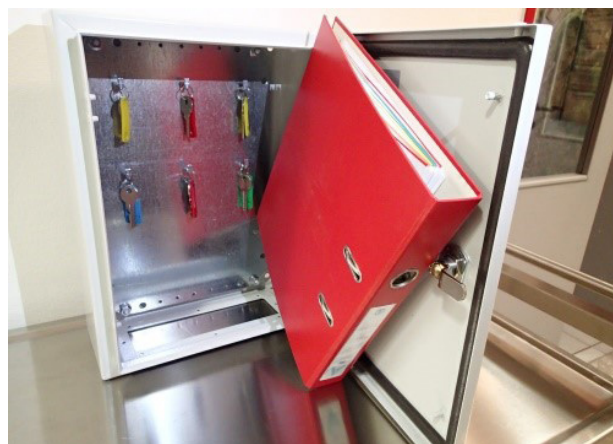
Slika 30: Omarica z dokumentacijo za gasilce, ki jo odpira gasilski ključ
